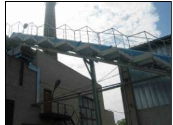
4 MW biokuro katilinė (UAB „Kretingos šilumos tinklai“)
